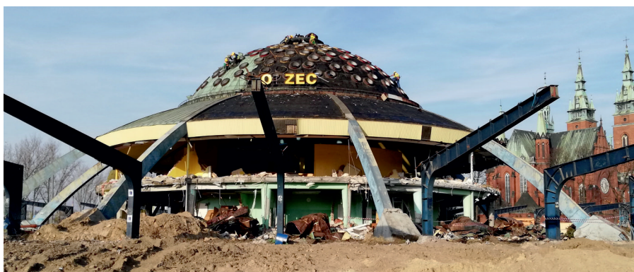
Stan budynku na początku listopada. Ze „spodka” zdjęto elewację i dach wraz z charakterystycznymi kopułkami.
