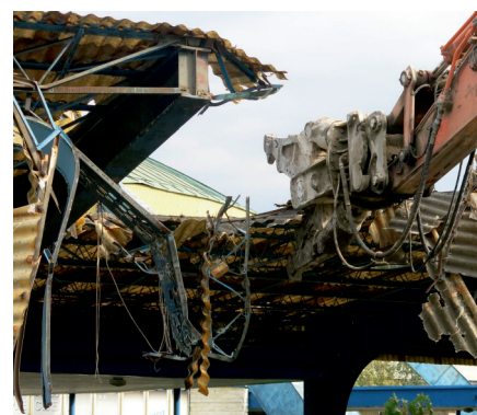
Szybko zostało zdemonstrowane nieestetyczne zadaszenie nad peronami.
